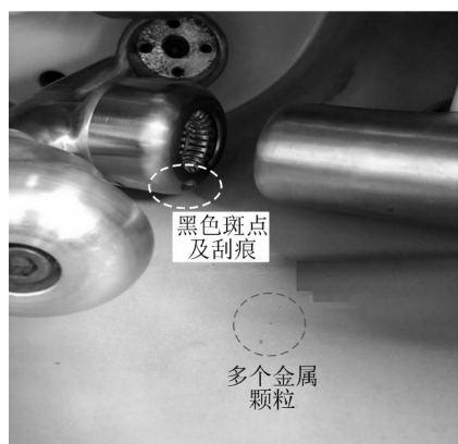
图9 1282开关气室开罐情况
